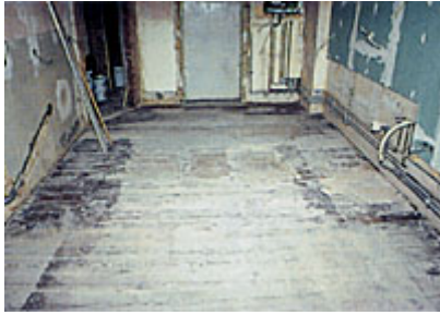
Ein typischer Untergrund in der Altbausanierung – nicht tragfähiger Holzdielenboden
