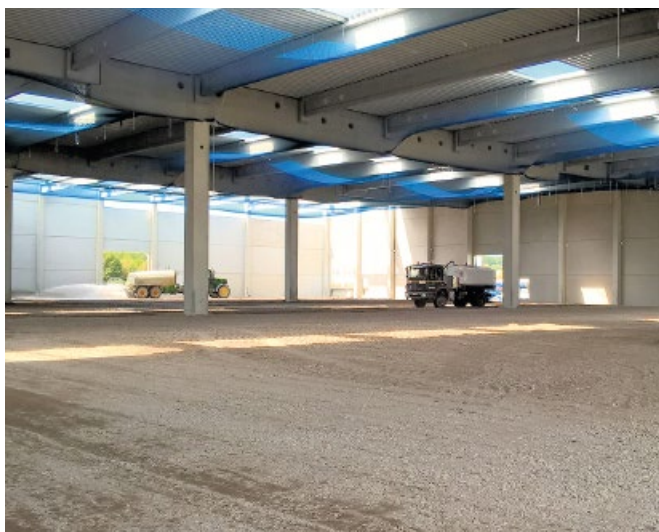
Bild 1 Vorbereitung des Bodens für die Betonage Preparing the floor for the concrete
