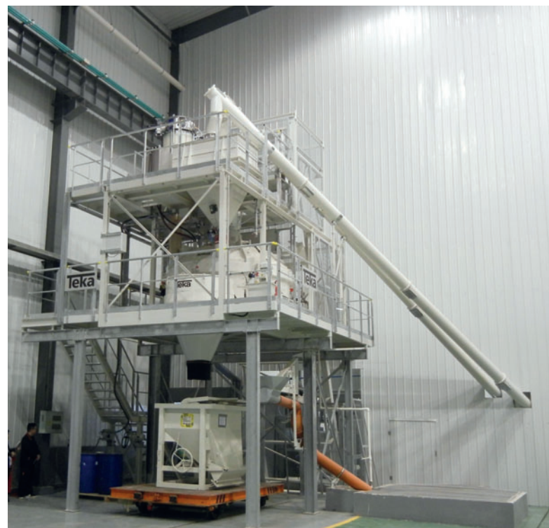
Installation de mélange de Teka
